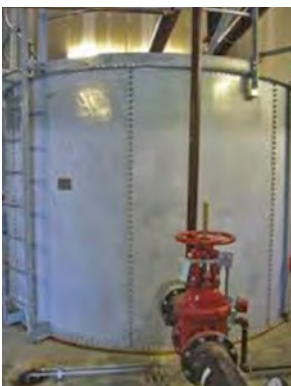
Exemple d'un réservoir d'eau secondaire en acier de 60 000 litres (15 000 gallons). Les réservoirs de ce type sont généralement ancrés au sol pour les empêcher de glisser ou de basculer pendant un tremblement de terre.
