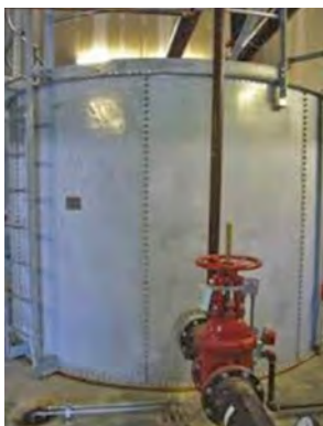
Exemple d'un réservoir d'eau secondaire en acier de 60 000 litres (15 000 gallons). Les réservoirs de ce type sont généralement ancrés au sol pour les empêcher de glisser ou de basculer pendant un tremblement de terre.
